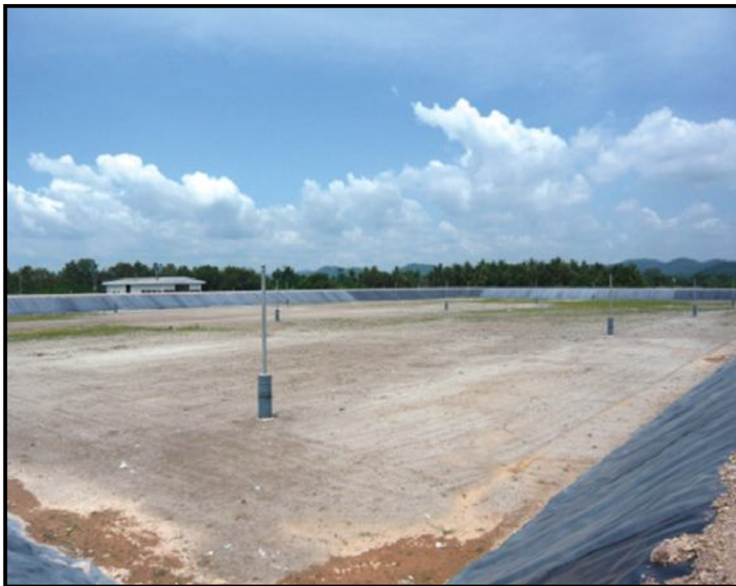
ภาพที่ 4 แสดงวิธีฝังกลบแบบขุดร่อง (Trench method)
