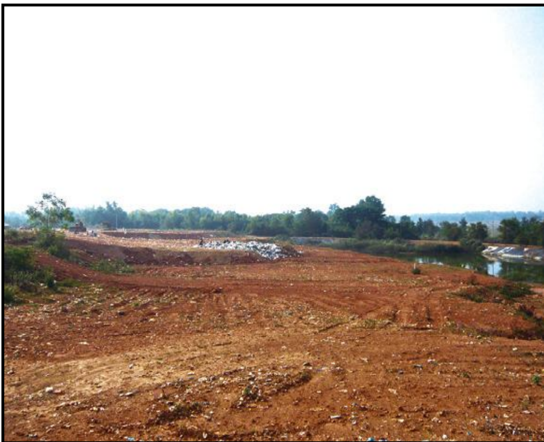
ภาพที่ 3 แสดงวิธีฝังกลบแบบพื้นราบ (Area method)
