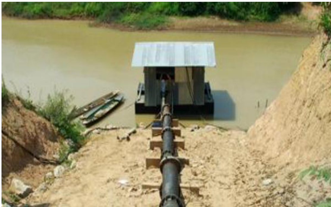
ภาพ 11 แสดงสถานีสูบน้ำแบบปั๊มหอยโข่งติดตั้งบนแพเหล็ก
