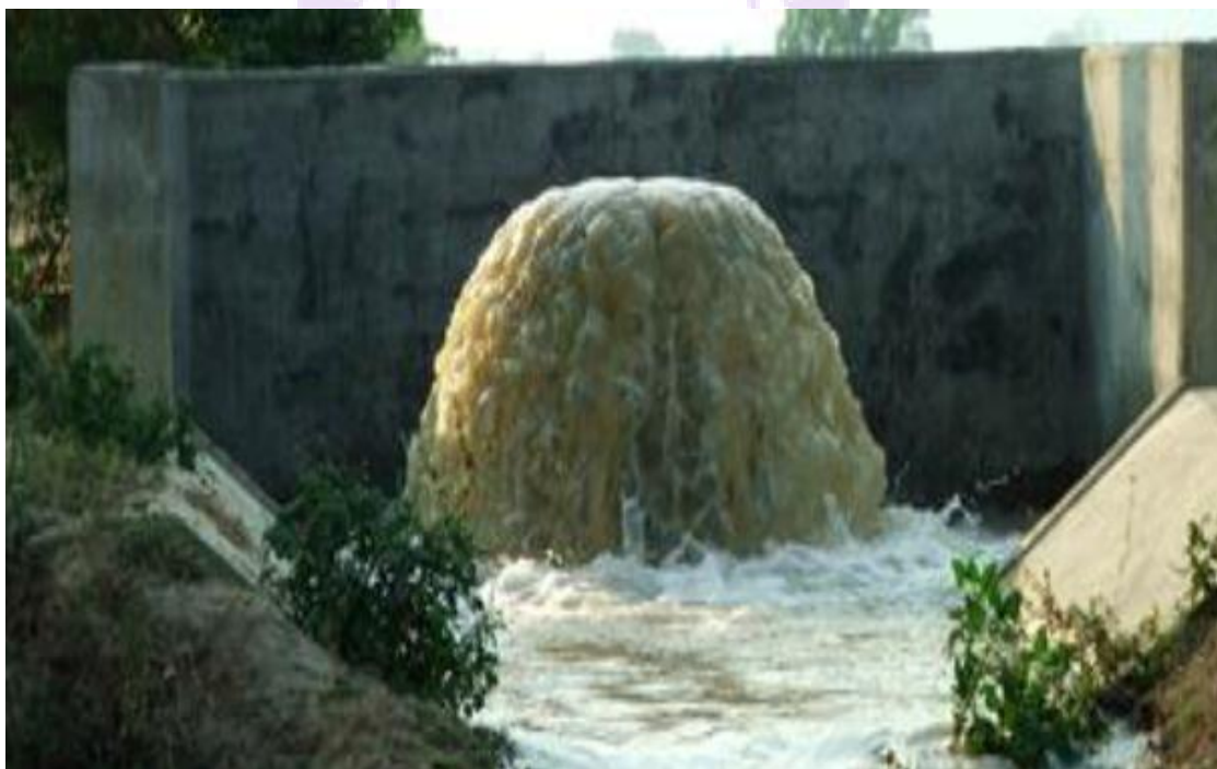
ภาพ 12 แสดงบ่อพักน้ำ
