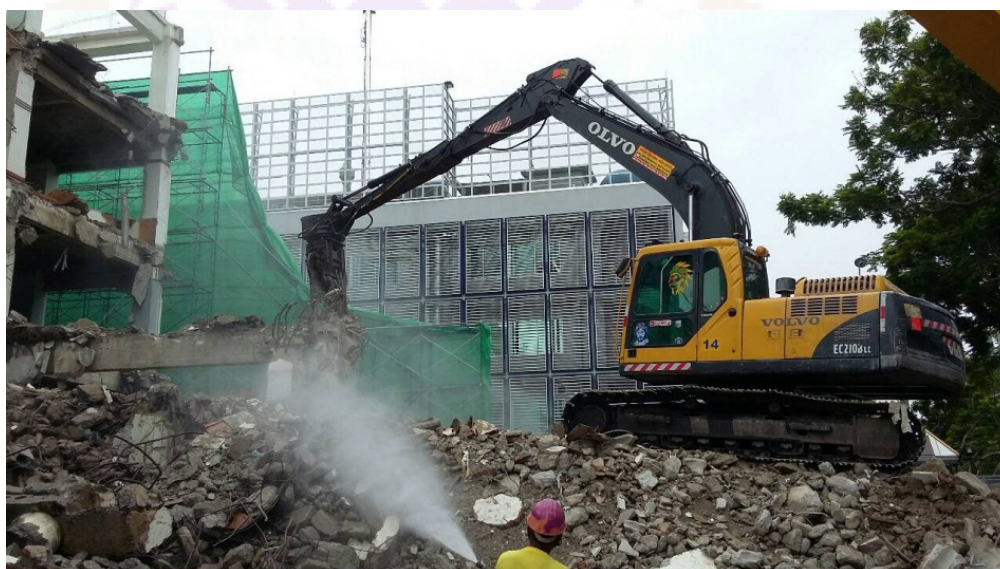
ภาพ 26 แสดงภาพถ่ายเศษคอนกรีตจากการรื้อถอนอาคาร
