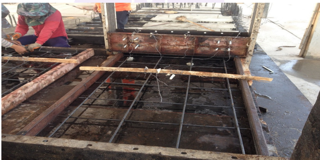
ภาพ 58 แสดงการติดตั้งแถววัดความเครียดที่ผนังคอนกรีตหล่อสำเร็จ
