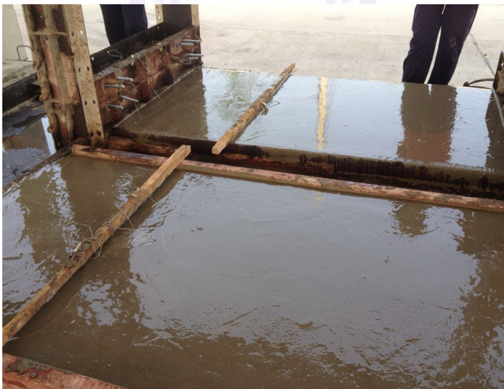
ภาพ 59 แสดงการเทคอนกรีตทำตัวอย่างส่วนผนังังคอนกรีต
