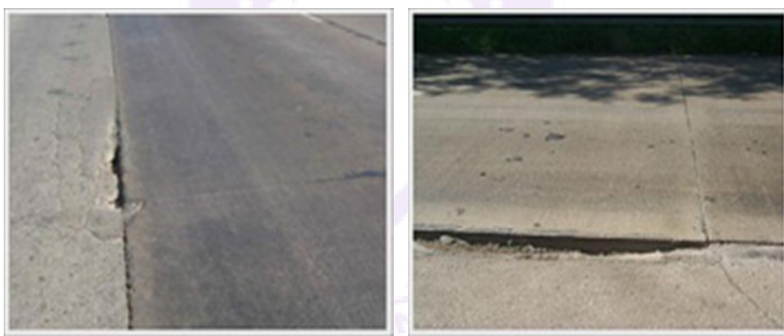
ภาพ 5 แสดงโพรงขนาดใหญ่ที่รอยต่อระหว่างผิวถนนคอนกรีตกับไหล่ทางลาดยาง
