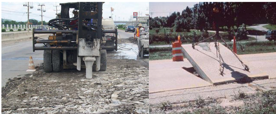
ภาพ 40 แสดงการนำแผ่นพื้นคอนกรีตออกโดยวิธีทุบให้แตกหรือวิธียกออก
