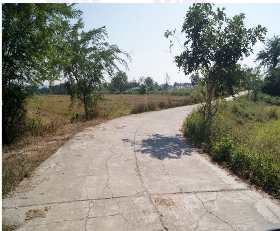
ภาพ 46 แสดงถนน คสล. ที่เสียหาย สายบ้านไชยเจริญ-บ้านด้ายกุ่มแก้ว ระยะทาง 4x1,100 เมตร
