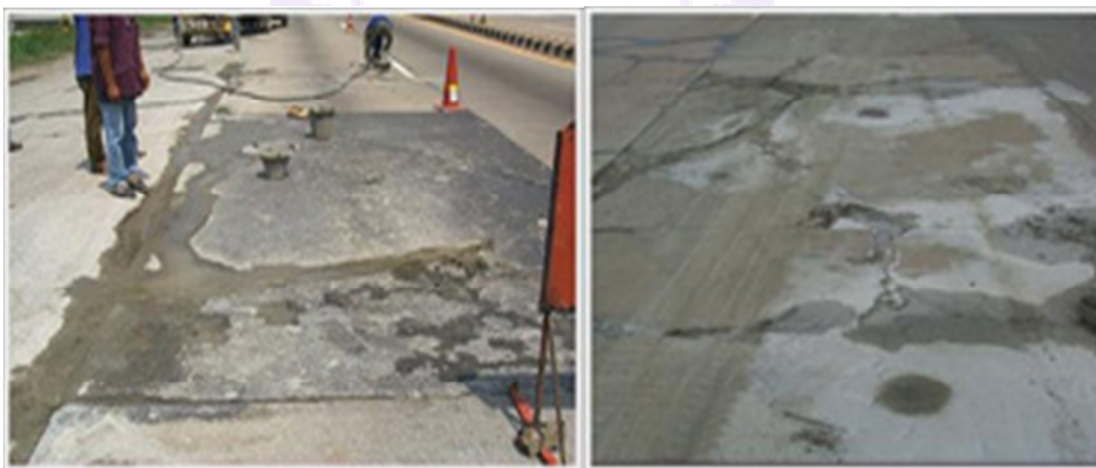
ภาพ 9 แสดงการอัดน้ำปูนต่อไปจนเต็มโพรงใต้แผ่นคอนกรีต
