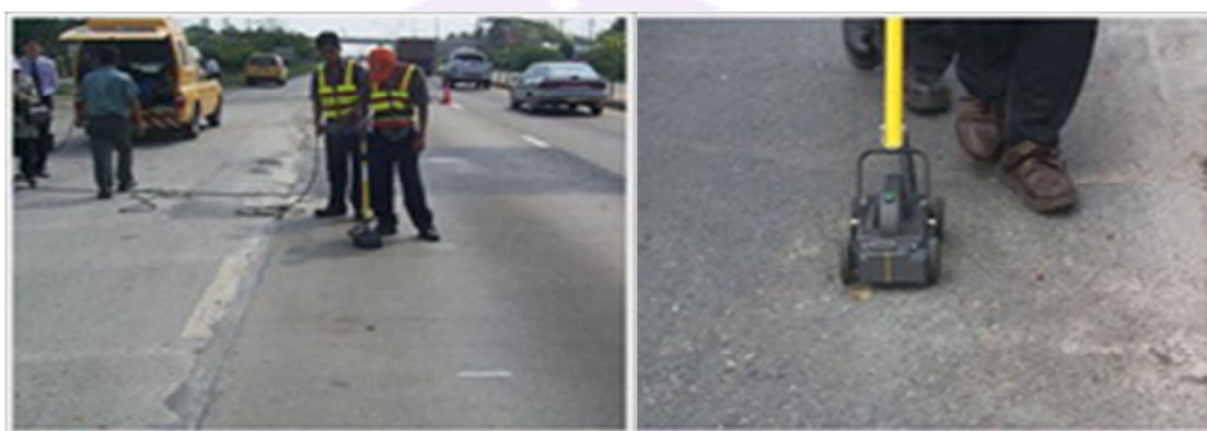
ภาพ 6 แสดงการตรวจสอบโพรงใต้พื้นถนนคอนกรีต
