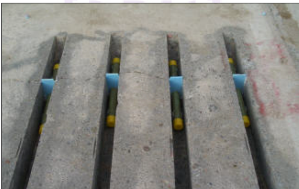
ภาพ 23 แสดงตัวอย่างของการซ่อมแซมระบบถ่ายน้ำหนัก (Load Transfer Restoration)
