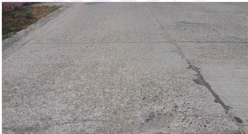
ภาพ 48 แสดงถนน คสล. ที่เสียหาย สายบ้านหนองหล่ม-บ้านท่าสาย ระยะทาง 4x3,200 เมตร
