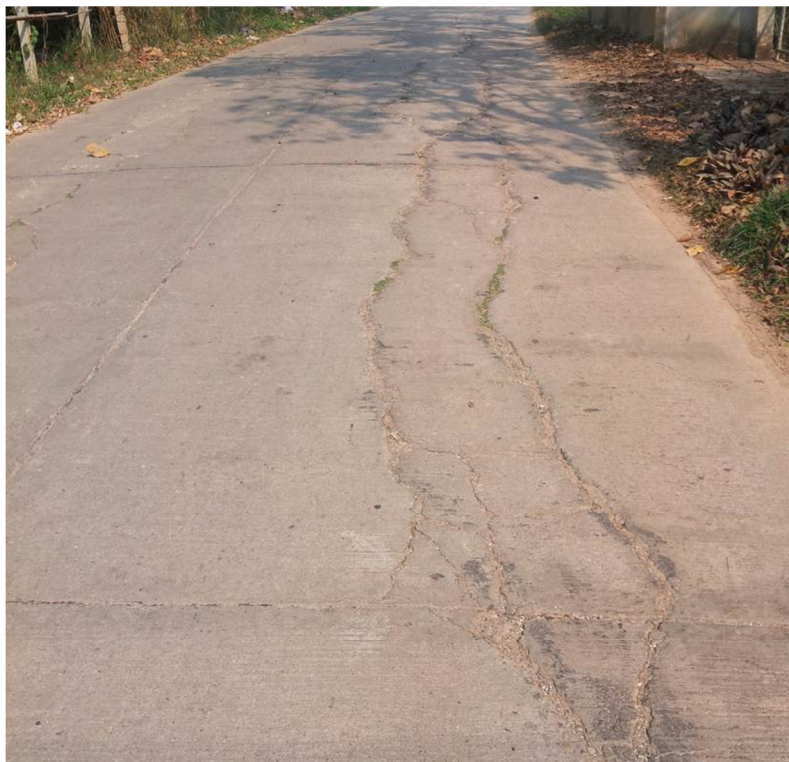
ภาพ 47 แสดงถนน คสล. ที่เสียหาย สายบ้านด้ายท่าล้อ-บ้านโพธิ์ชัย ระยะทาง 4x2,450 เมตร
