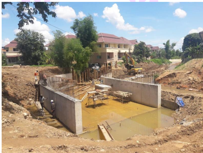
ภาพ 13 แสดงคคองระบายน้ำ ค.ส.ล. รูปตัวยู
